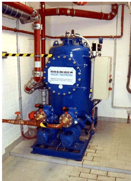
Abbildung 4: Vakuumpumpe in der KfW [10]
