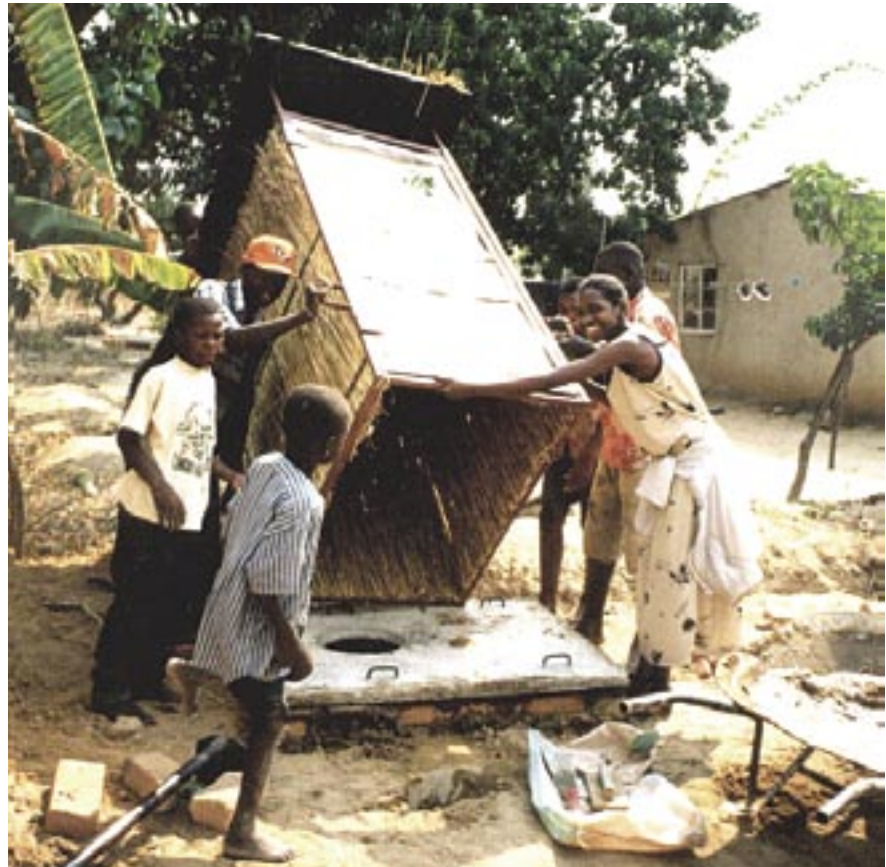
Fossa Alternata latrine in Zimbabwe.
