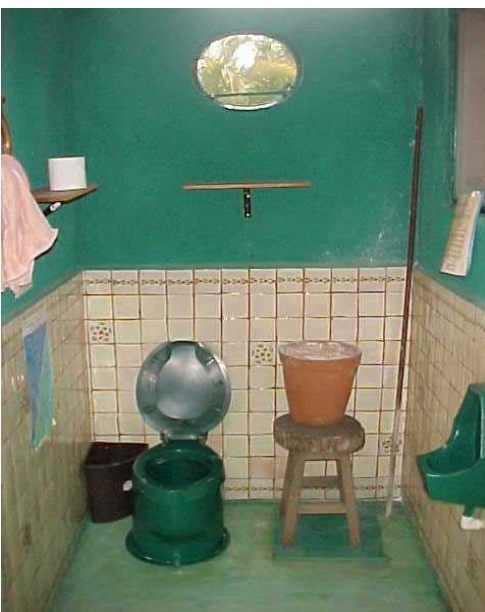
Instalación de separación en seco, edificio residencial en México, (Fuente: S. Esrey, UNICEF, Nueva York)
